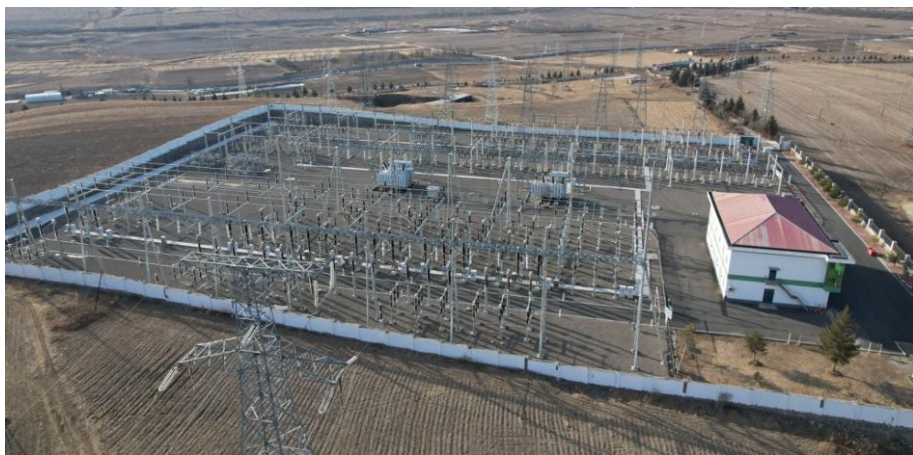
汪清 220kV 变电站现状
